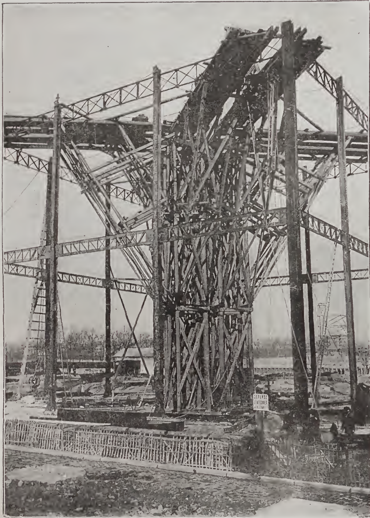
LES CHARPENTES MÉTALLIQUES. — Échafaudage en porte-à-faux, au coin de la rue Saint-Dominique et de l'Esplanade des Invalides.
